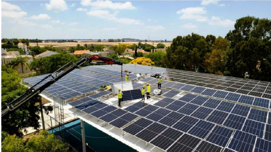
"تركيب ألواح شمسية على سطح مبنى - توليد طاقة من مصادر متجددة وتوفير ظل فوق ملعب رياضي في موشاف تسروفا | مقدمة من شركة الطاقة E.D.I."
